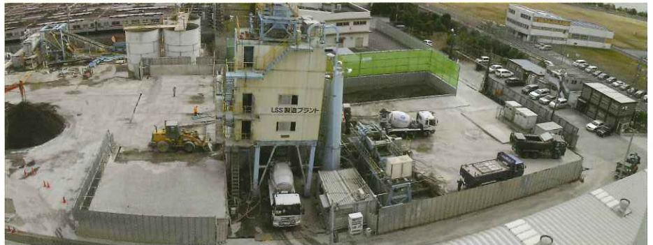
⑤ 都市部に設置された常設プラント（発生土・泥土の資源化プラント）の例
