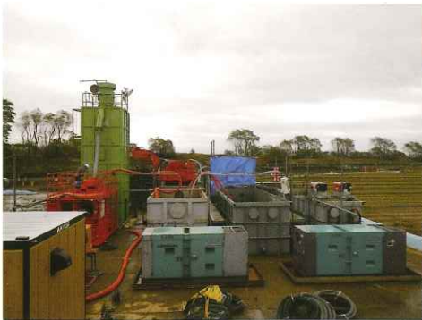
⑥ 中規模仮設プラントの例
