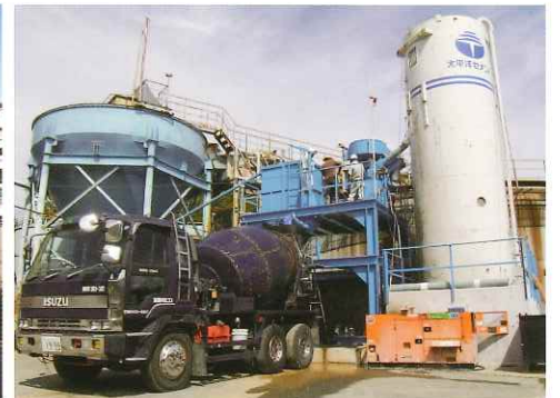
⑧ 簡易常設プラントの例
