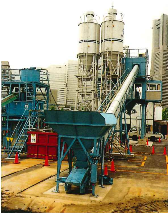
⑤ 仮設固定式プラント
